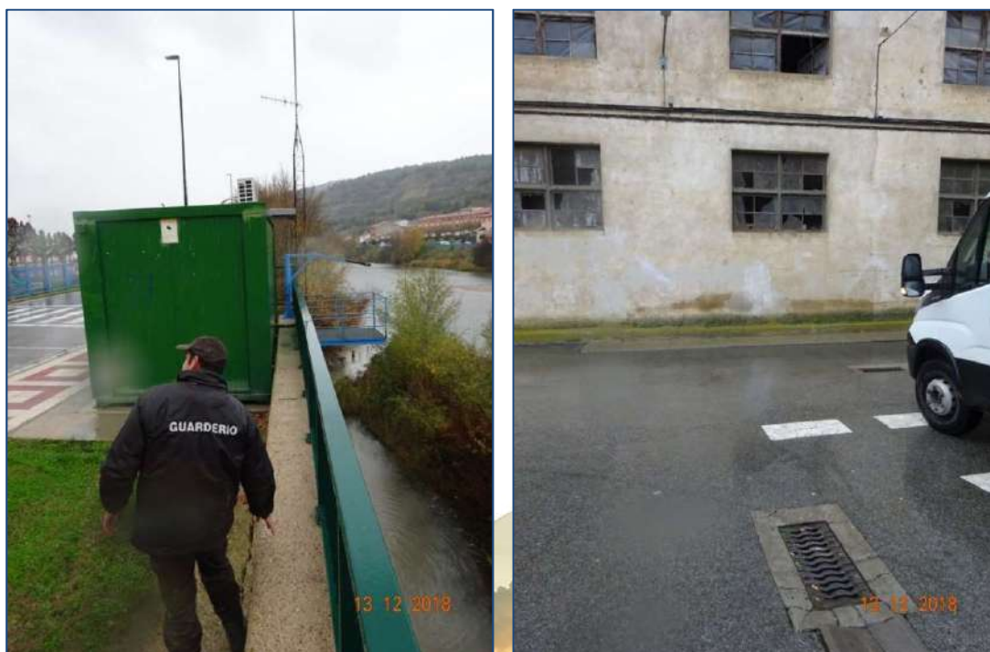
Ilustración 57. Estación de aforo de la CHE y alcantarillado próximo.
